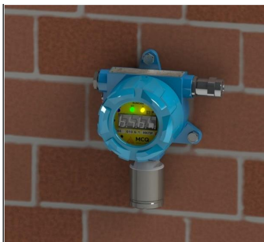
Вид газоанализатора, установленного на стену
